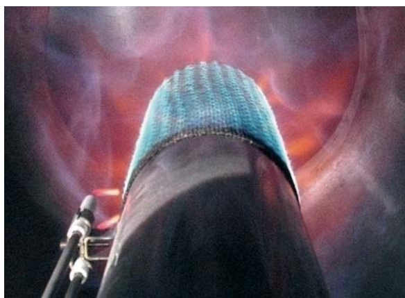
Głowica palnika bezpośredniego spalania podczas pracy (widoczna modulacja mocy)
